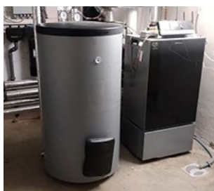
Abb. 37: Speicher und Wärmepumpengerät
