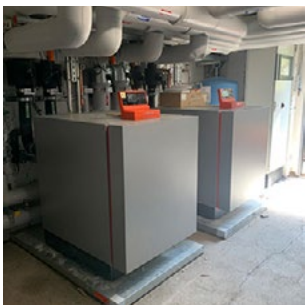
Abb. 52: Wärmepumpen im Keller
