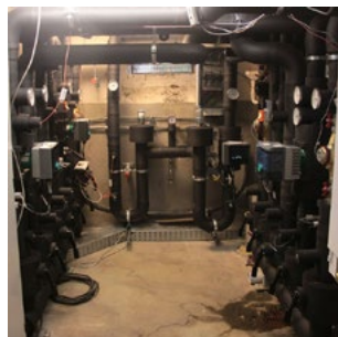
Abb. 53: Hydraulik der Quell-Erschließung im Keller
