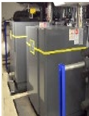
Abb. 44: HT- und NT-Wärmepumpe
