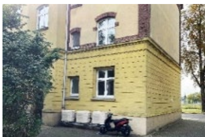
Abb. 42: Installierte Außeneinheiten an Demonstrationsgebäuden
