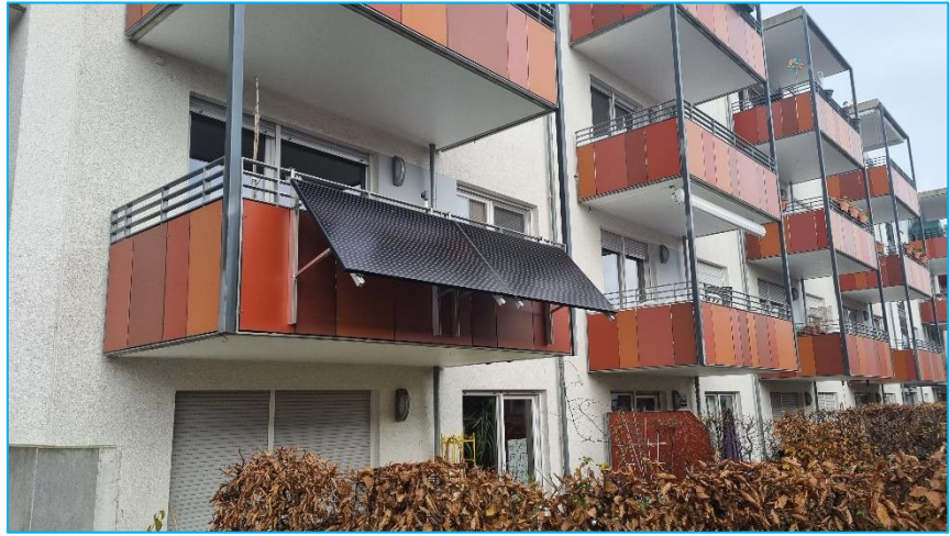
Abbildung 3: Schräg montierte PV-Module am Balkon an einem MFH in Heidelberg (Quelle: Baugenossenschaft Neu Heidelberg)
