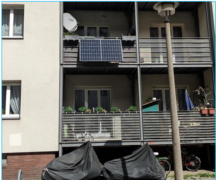
Abbildung 4: Schräg montiertes PV-Modul an einem Balkon. (Quelle: GdW)
